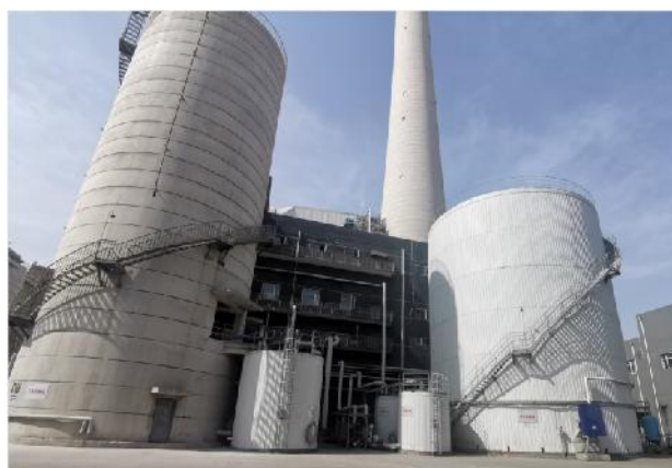
石灰石仓（事故浆液箱）
