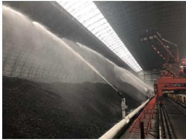
煤场（喷淋系统）
