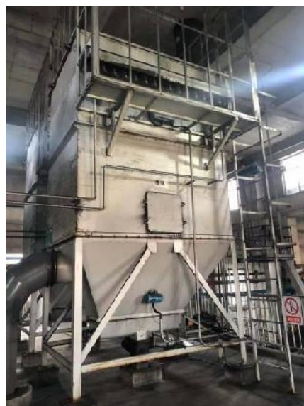
碎煤机室除尘器
